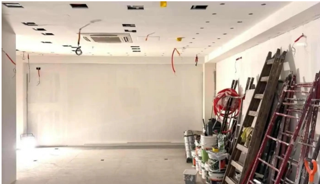
Bazzanos instalaciones electricas firma instaladora autorizada por ute del propietario
