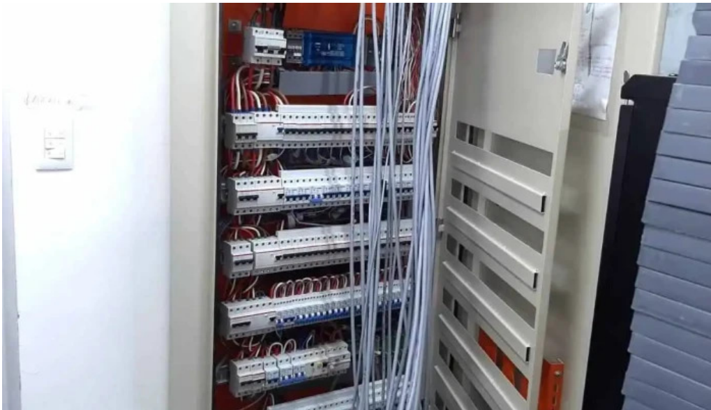
Bazzanos instalaciones electricas firma instaladora autorizada por ute instalaciones
